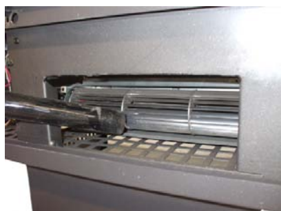
Fig. 38 - Nettoyage de le ventilateur ambiant
